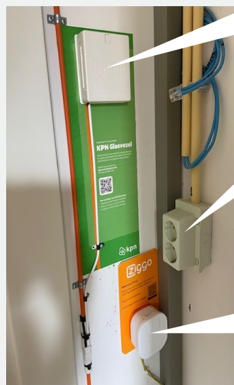
Glasvezel-aansluiting KPN in de meterkast
